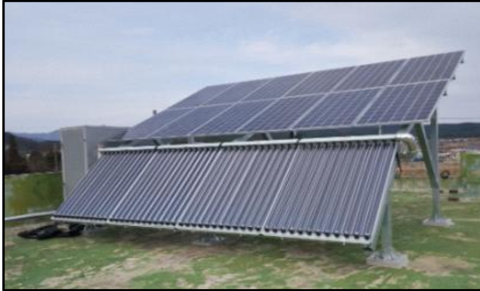
건물 옥상내 태양광 +태양열(융.복합) 시설
