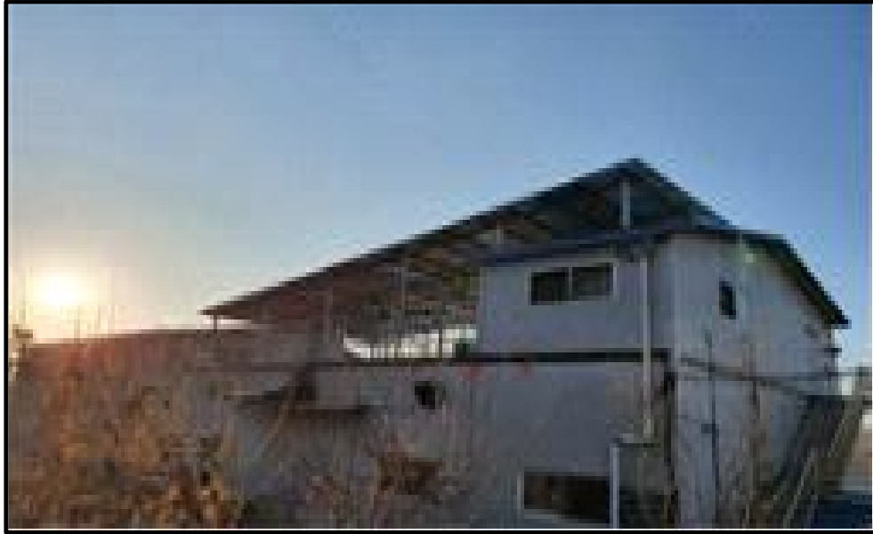
건물 옥상내 태양광 시설
