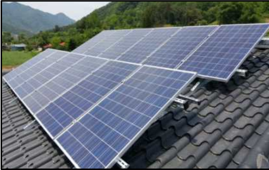
주택 지붕위 태양광 발전 시설
